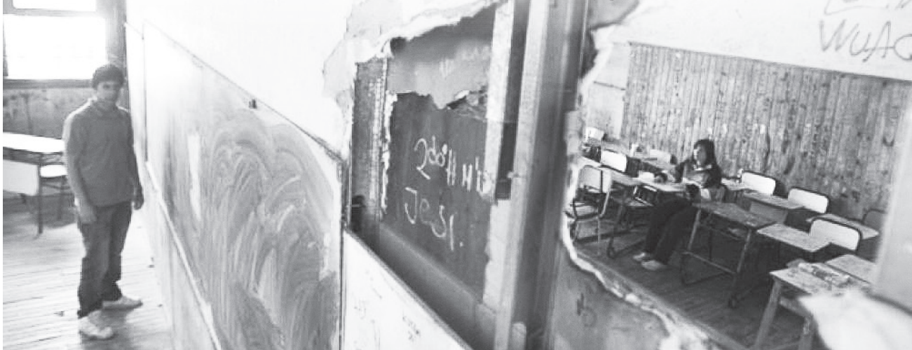
Córdoba 2014. Huevo en la pared que divide dos aulas
